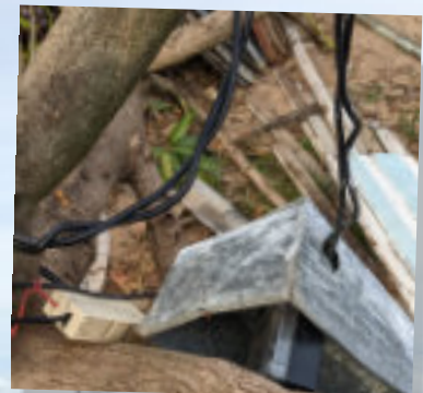
Schäden am Stromnetz
